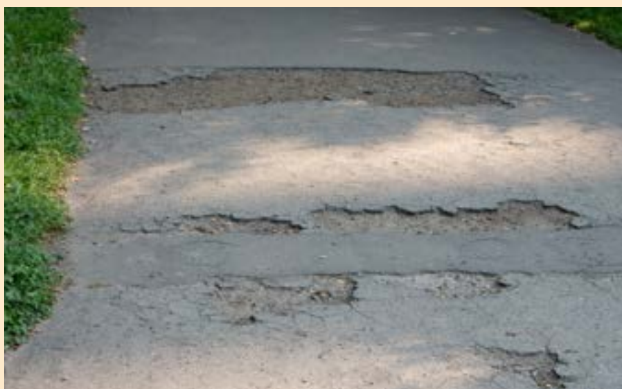
Nawierzchnia parkowych alejek wymaga remontu
